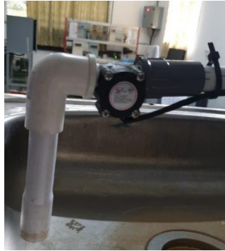
Gambar 4. Sensor Flowmeter yang digunakan
