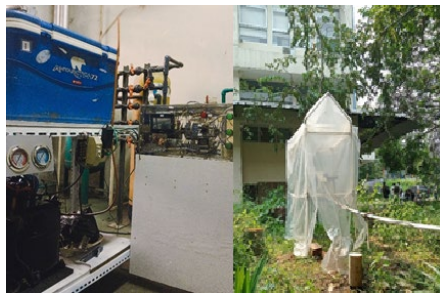
Gambar 3. Instalasi Water Chiller Hidroponik dan Green House
